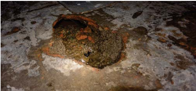
99. Gat in de keldervloer van de houtkelder.
