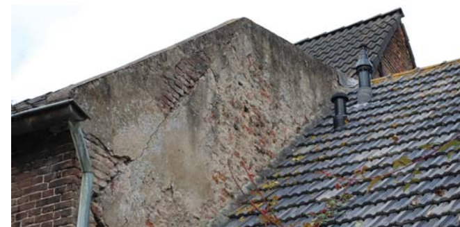
Afb. 54: Schuine scheur met boven nieuw metselwerk en onder oud
