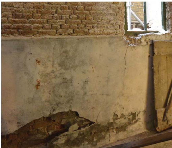
Scheurend en loslatend pleisterwerk, raam B rechts.
