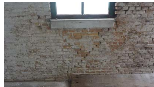
Scheur onder raam P en missend voegwerk rechts.
