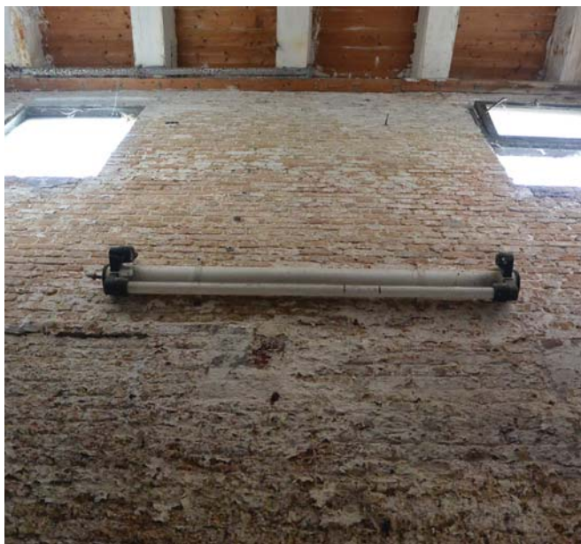
75. Afbladderend pleisterwerk door vocht en zouten.
