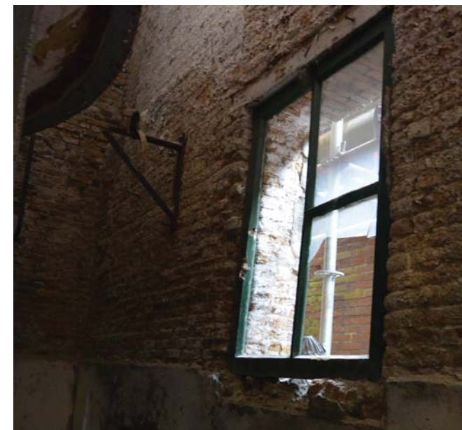
86. Kapotte roede en ruitjes, mogelijk door vandalisme.
