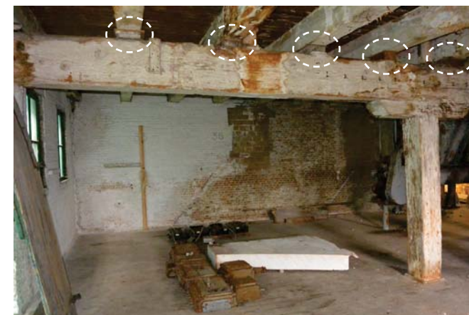
66. Klosjes onder de vloerbalken bij de voorgevel op de tweede verd.
