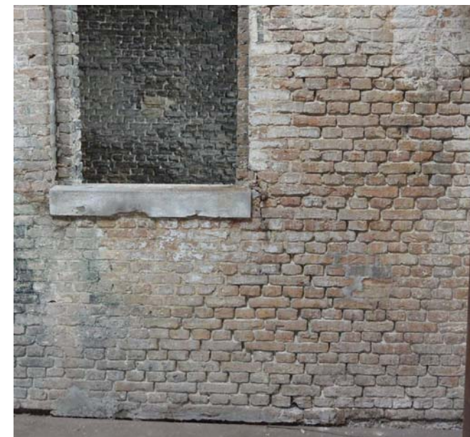
77. Missend voegwerk op de derde verdieping (zuidkant).
