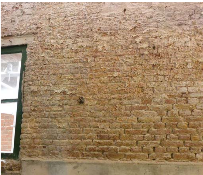
Metselwerk met zoutuitbloei en missend voegwerk.
