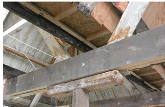
Verrot spantbeen, vervangen goot, vervangen spantbalk.
