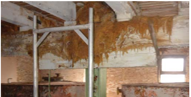
Vervezeling van vloerbalken boven stalen kolom.
