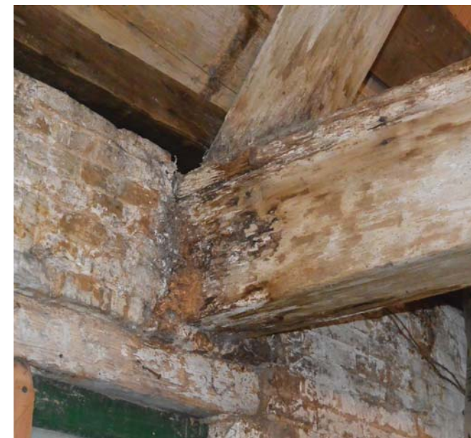
80. Verrotte balkkop van spant 2.
