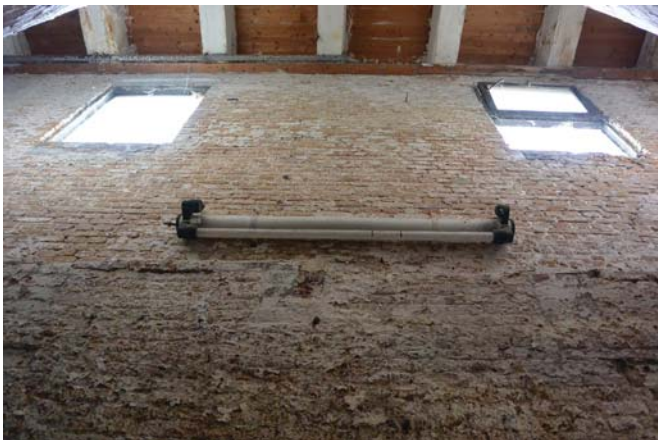
Metselwerk met zoutuitbloei en de vensters D en E.
