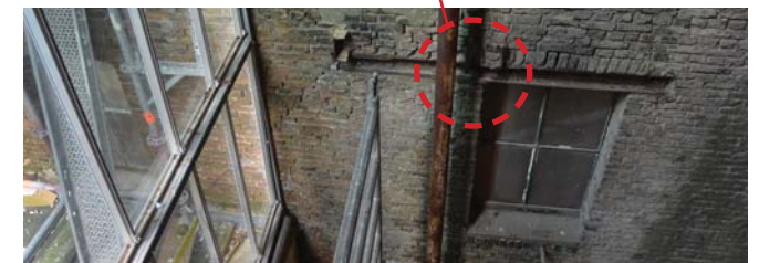
83. Boven uitbuiend metselwerk, onder stalen latei aan andere kant.
