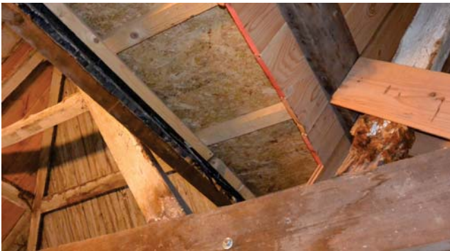
57. Zakgoot aan de westkant, verrot en geheel vervangen.
