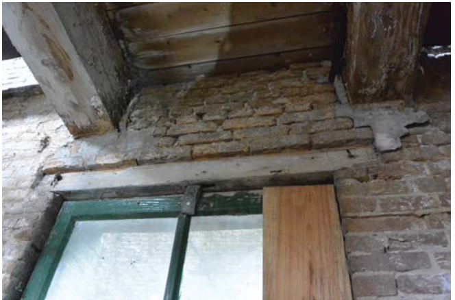
Uitgebuikt metselwerk boven raam H.
