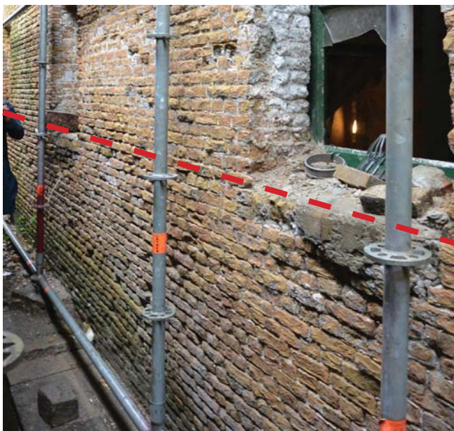
76. Missend voegwerk in een strook van ca. 1,5 m hoog (noordgevel).
