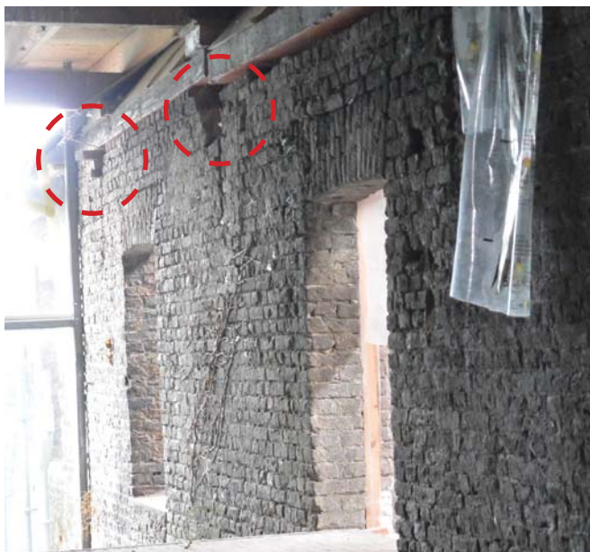
87. Missende schieters van de gevelankers.
