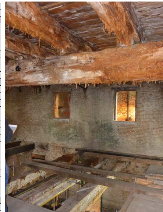
Vervezeling balken en missende vloer.
