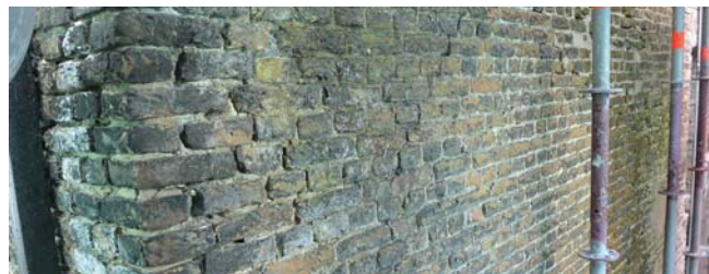
68. Scheuren in het metselwerk rond de hoeken.
