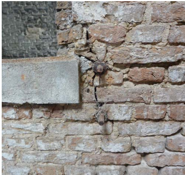
82. Roestende bouten drukken het metselwerk uit elkaar.
