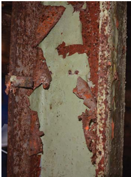
81. Roestende staalconstructie, begane grond.
